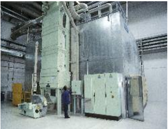
Im Jahr 2000 errichtete HARTMANN am Standort Herbrechtingen/Deutschland eine weltweit einzigartige Separationsanlage für den Produktionsausschuss bei der Herstellung von Inkontinenzprodukten.
